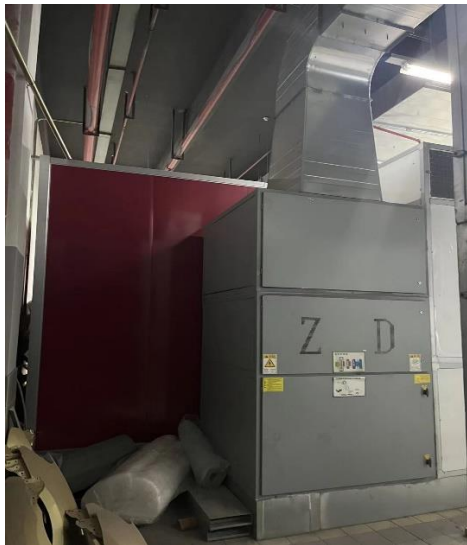
1号烤漆房废气处理设备
