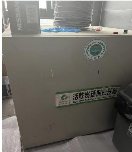
调漆房废气处理设备
