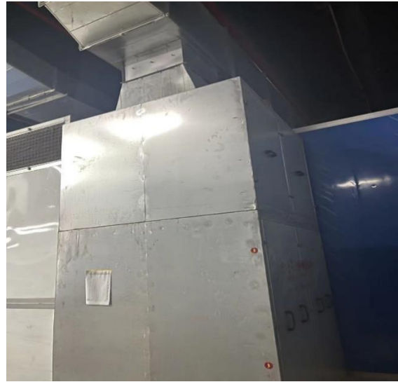
2号烤漆房废气处理设备
