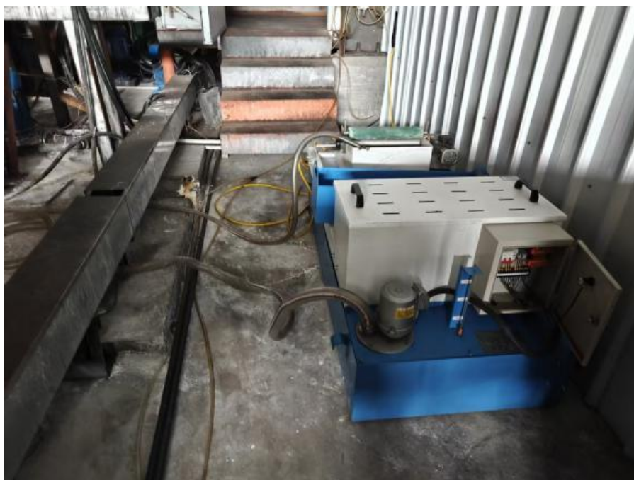
图3-2 废水处理设施现场照片
