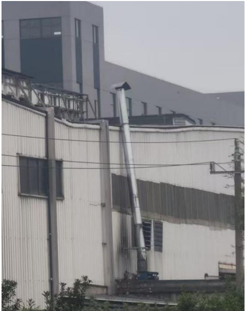
DA001 轧机油雾排气筒
